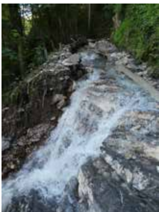
Ein Teil der vom Hochwasser weggeschwemmten Hauptversorgungsstraße von Falkenstein zum Petersberg und zur Hohen Asten am 04.06.24, einen Tag nach dem katastrophalen Starkregen.
